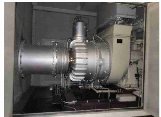
非常用発電設備の設置
