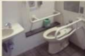
車いす対応トイレ
