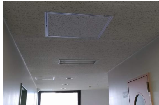
■不使用箇所の消灯（事務所ビル）
