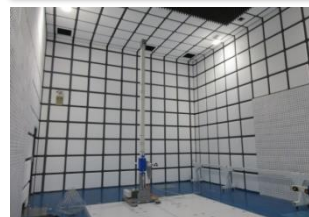
電波暗室（3m法）
