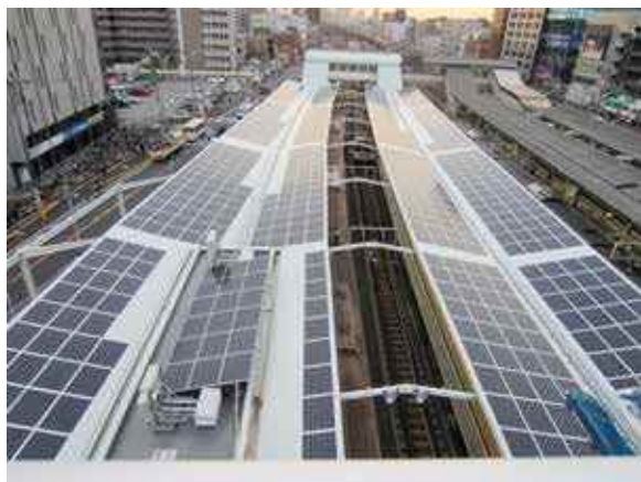
図表2-5-4 西船橋駅の太陽光発電システム
