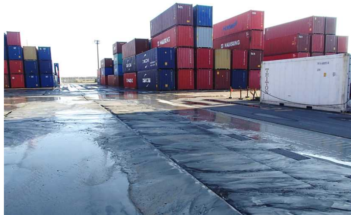
コンテナヤードの液状化
