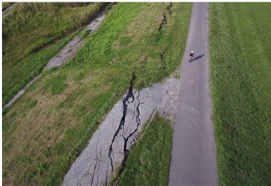
堤防の被災状況(亀裂)【9月6日】
