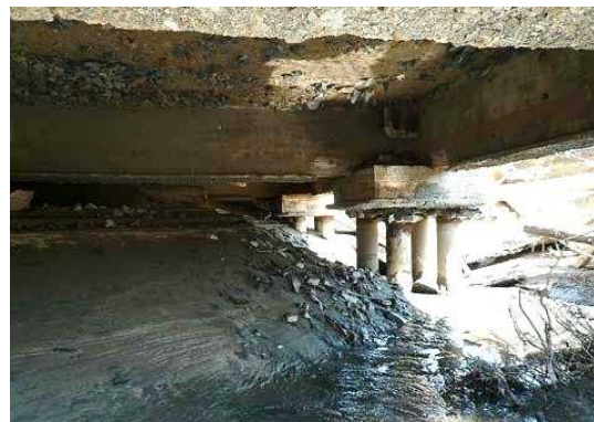
建物基礎が露出
