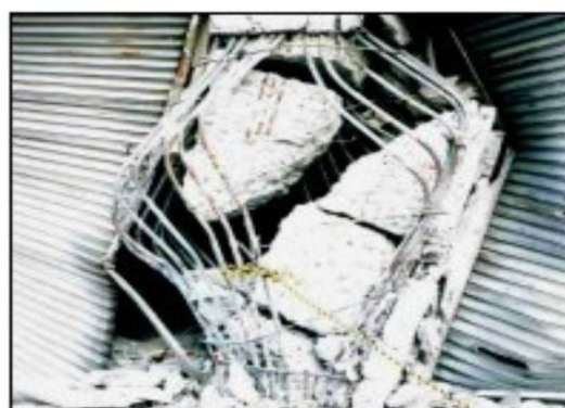
店舗1階柱の圧壊
