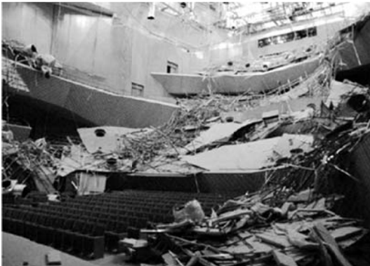
ホール天井の脱落
