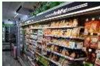
コンビニ空調・ショーケース
