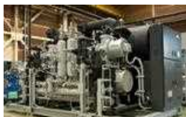
高効率冷凍機 (前川製作所)
