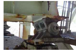
<橋梁の支承・主桁の損傷>
