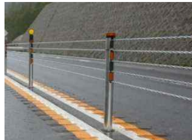
＜ワイヤロープの設置事例＞
