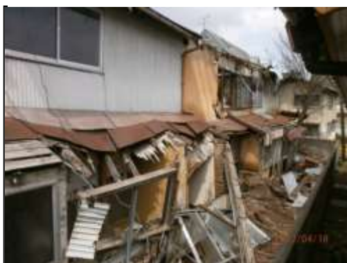
写真2 再建築できない敷地
