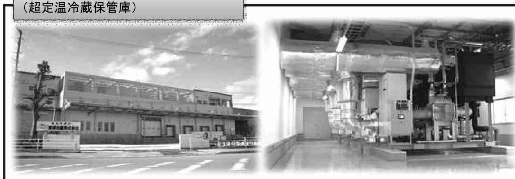
省エネ自然冷媒冷凍等装置導入事例 (超定温冷蔵保管庫)
