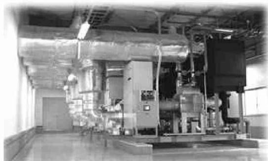
中央方式冷凍冷蔵機器
