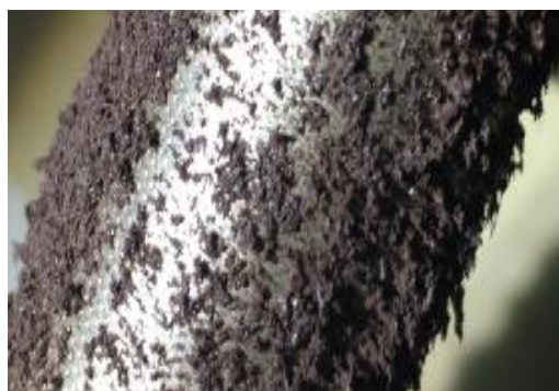
砂状のスラッジ
