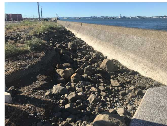
南本牧ふ頭 裏込損傷
