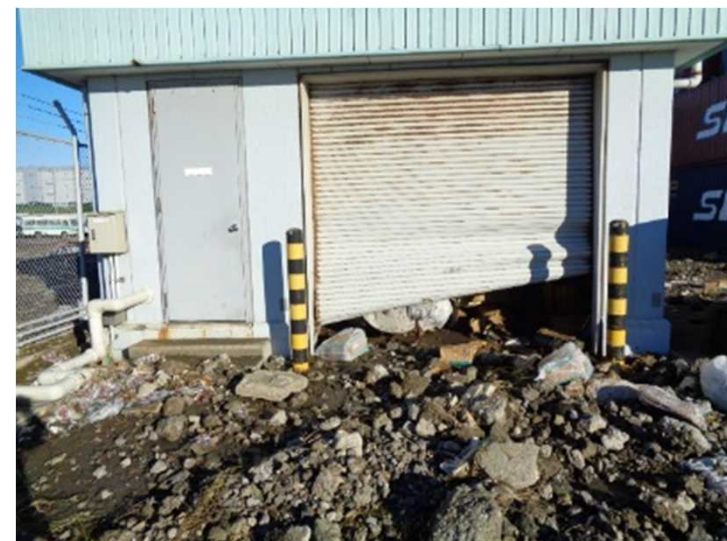
マリンハウス倉庫(川崎市)の破損
