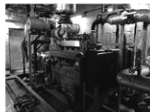
非常用電源装置のイメージ
