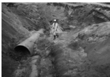
厚真町では、国が造成したパイプラインで管の継ぎ目が離脱するなど壊滅的な被害が発生
