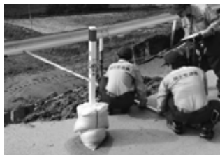
被災状況調査 (福島県二本松市)
