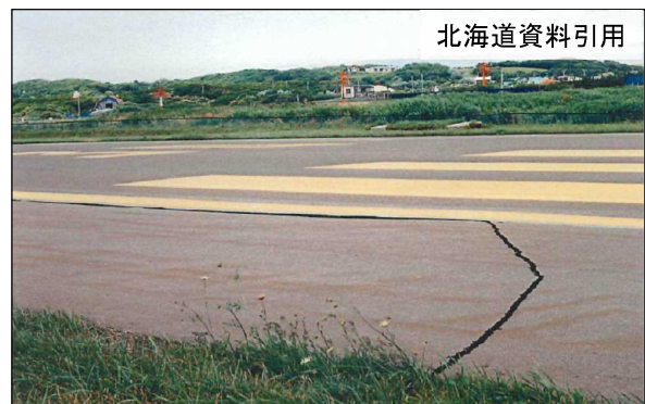
【滑走路に生じた亀裂の状況】
