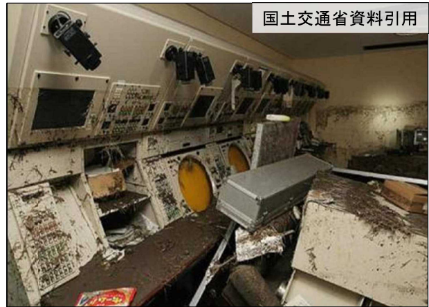
【レーダー管制室(管制塔1階)】
