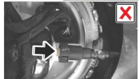
吐出パイプの亀裂点検
