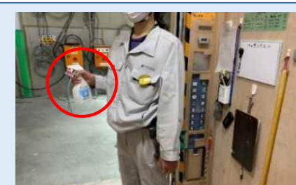
EVの操作盤等の消毒を徹底
