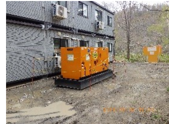
発動発電機の設置状況
