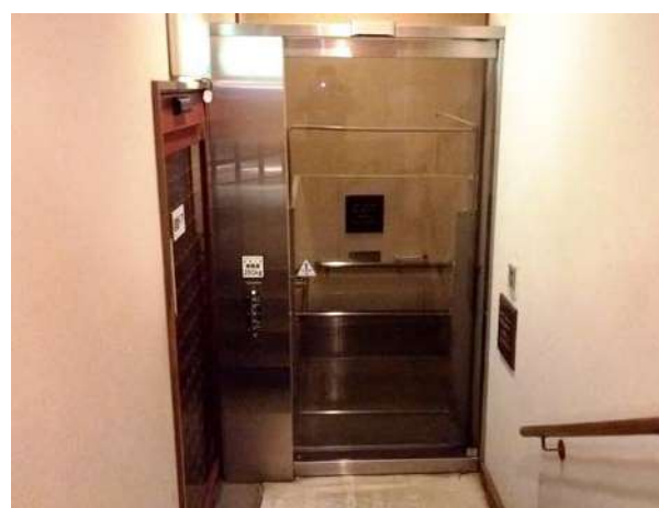
北殿（ほくでん）の段差昇降機
