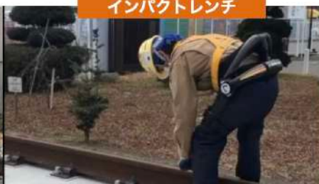
インパクトレンチ
