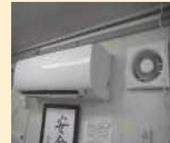
扇風機や換気扇とエアコンを併用
