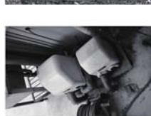
井戸水・ポンプ
