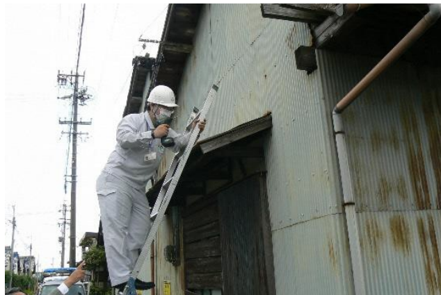
写真 7 危険な空き家に対する緊急措置の様子
