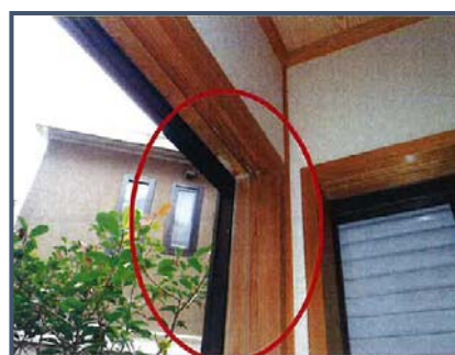
和室東側窓 鴨居等に染み
