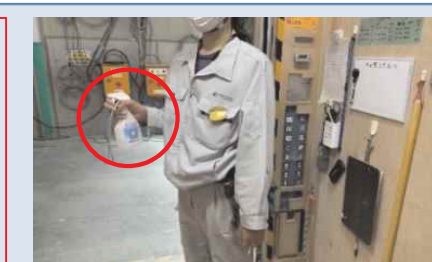
EVの操作盤等の消毒を徹底
