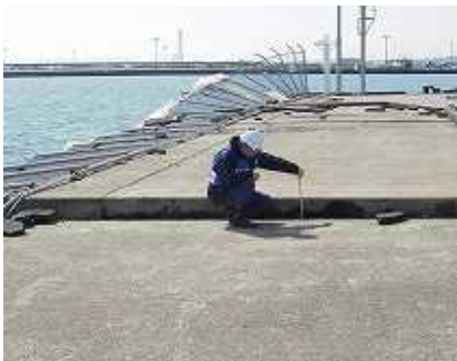
津波警報解除後の 現地調査(陸上)
