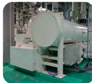
熱供給インバータターボ冷凍機
