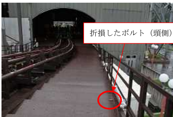
写真2 折損したボルト (頭部側) の落下位置 (ブレーキゾーンの足場)
