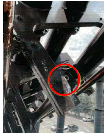
写真5 折損したボルトの 設置箇所
