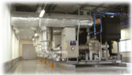
<中央方式冷凍冷蔵機器>
