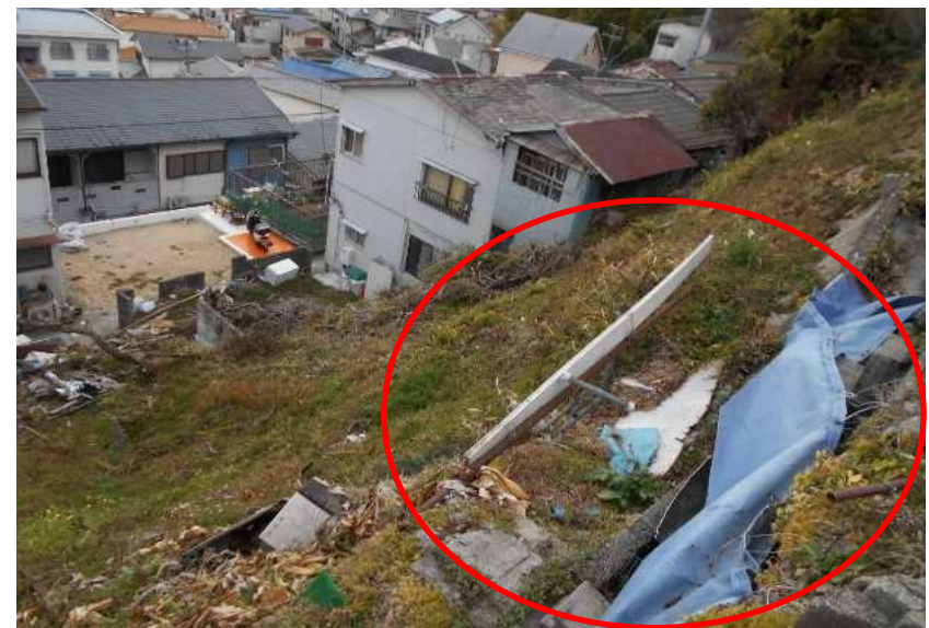
当該土地は高台に位置しており、強風・豪雨等の際には、 瓦礫や柵等の落下 が懸念されており、 低地の住民にとっては非常に危険な状況
