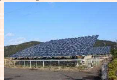
太陽光発電設備
