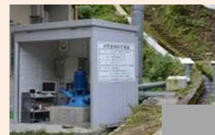
小水力発電設備
