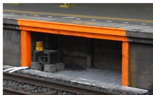
ホーム下の待避スペース
