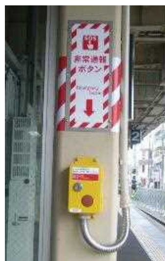
非常停止押しボタン
