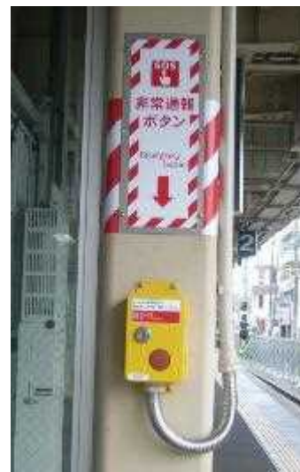
非常停止押しボタン
