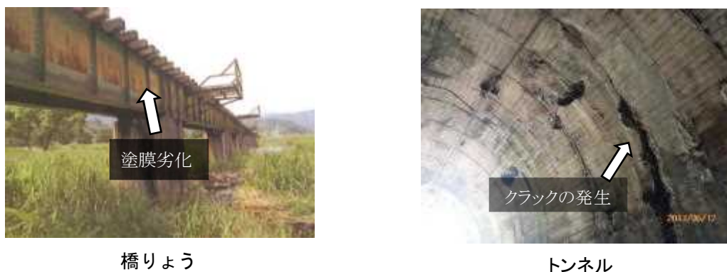
図4: 老朽化が進んでいる施設の例
