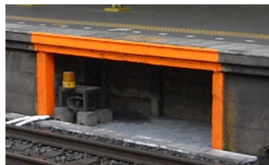
ホーム下の待避スペース
