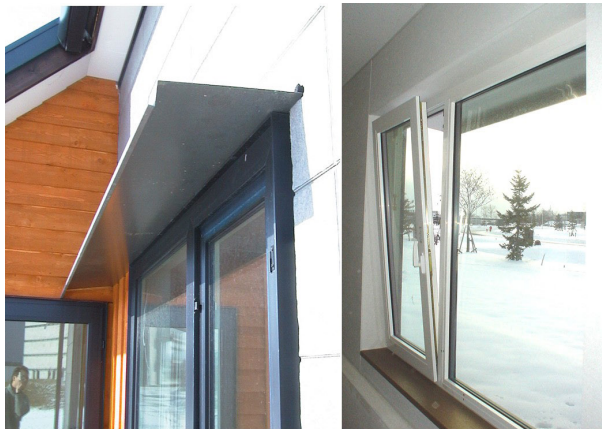
写真 3.3.1 常時開放に適したドレーキップの窓
