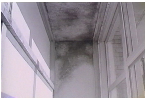
写真 2.1.2 すがもれによる被害
