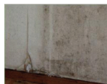
写真 4.1.2 カビによる汚損
