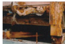
写真 4.1.3 結露による腐朽
