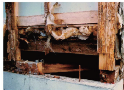
内部結露による躯体の腐朽
