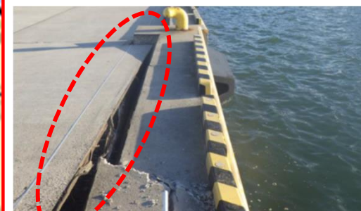
-7.5m岸壁のひび割れ
