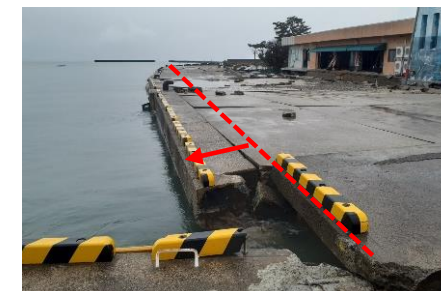
-5.5m岸壁のズレと沈下
