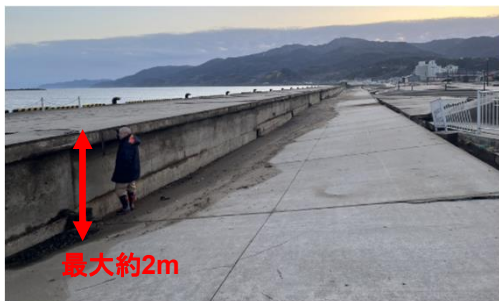
-7.5m岸壁背後荷捌き地の沈下
