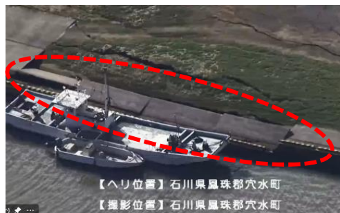
-4.0m物揚場の倒壊
