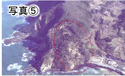
国道249号トンネル坑口崩落
