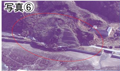
国道249号法面崩落
