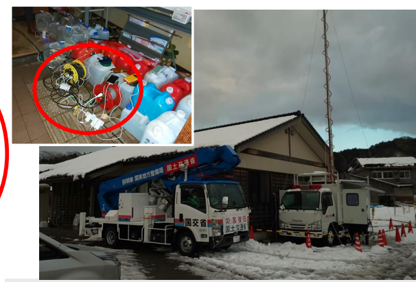
家電製品 (スマートフォン) に電力供給 (輪島市 諸岡公民館)
