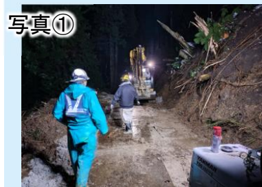
県道38号被害状況
