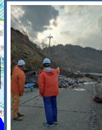
土砂崩落復旧前
