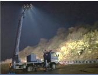
照明車 輪島市 夜間照明
