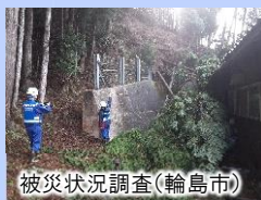
被災状況調査(輪島市)
