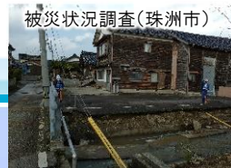
被災状況調査(珠洲市)
