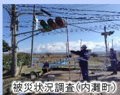
被災状況調査(内灘町)
