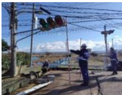
道路の被災状況調査 (石川県内灘町)
