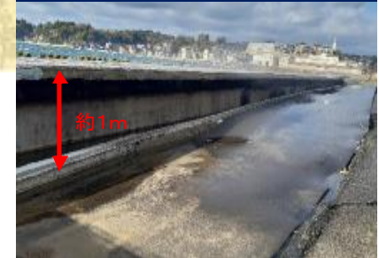
岸壁背後の沈下
