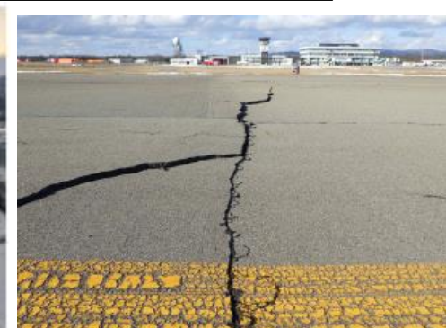
能登空港の被災（穴水町）
