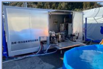
⑬ボイラーコンテナ
