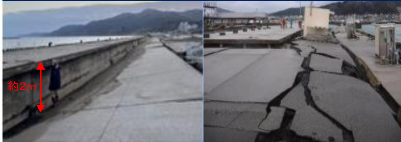
岸壁背後の沈下
