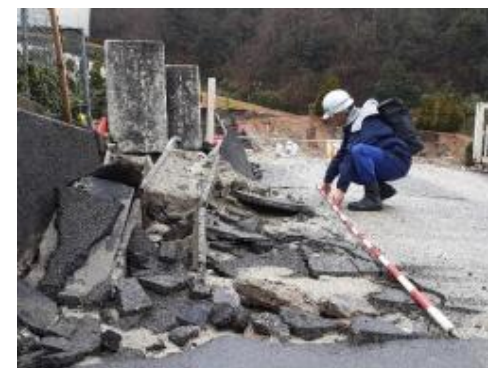
岩屋浄水場の被災（七尾市）
