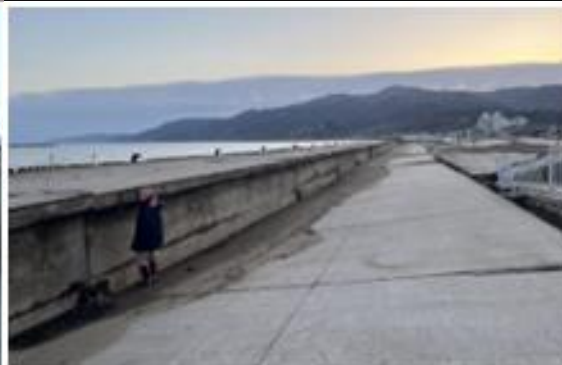
輪島港の被災（輪島市）
