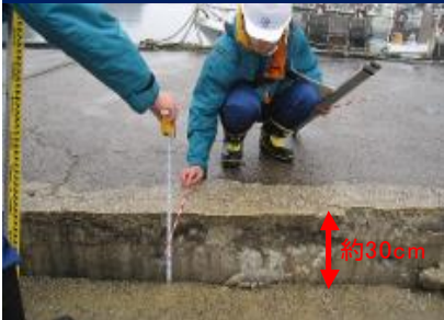
岸壁背後の沈下
