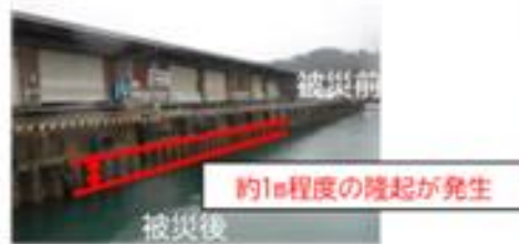
船だまりの被害状況
