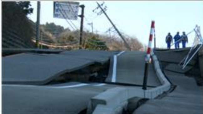
国道249号道の駅千枚田付近（輪島市）
