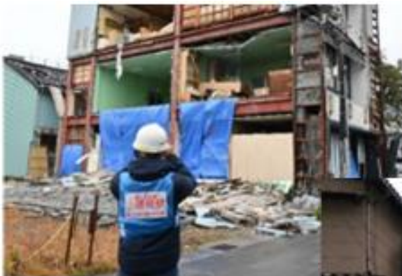
建築物の損壊状況（七尾市）
