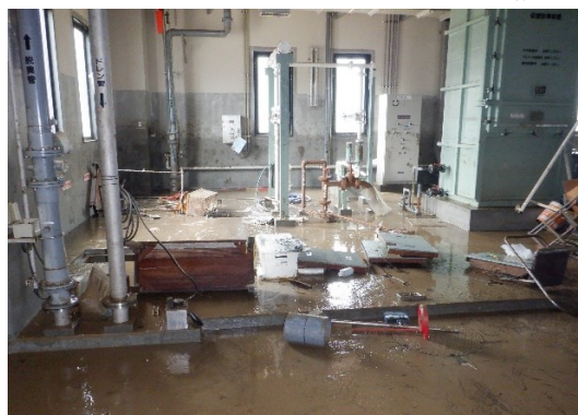
浸水した浄化センター内
