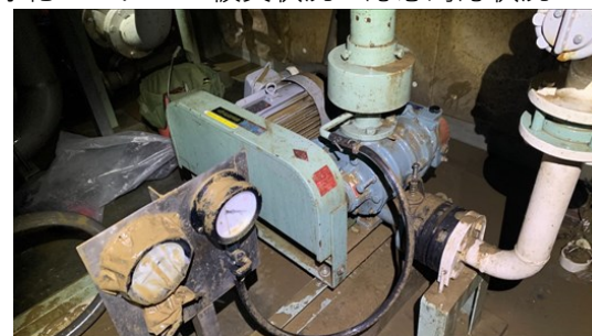
浸水した曝気ブロワ
