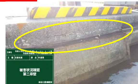
護岸のひび割れ
