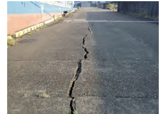
岸壁のひび割れ
