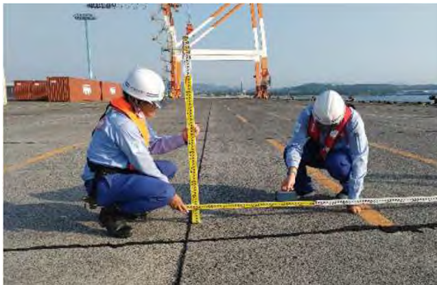
エプロン部コンクリート 舗装の沈下
