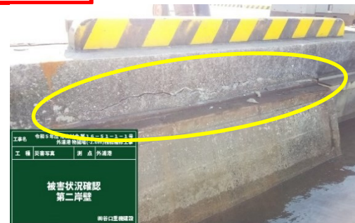
護岸のひび割れ
