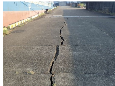
岸壁のひび割れ
