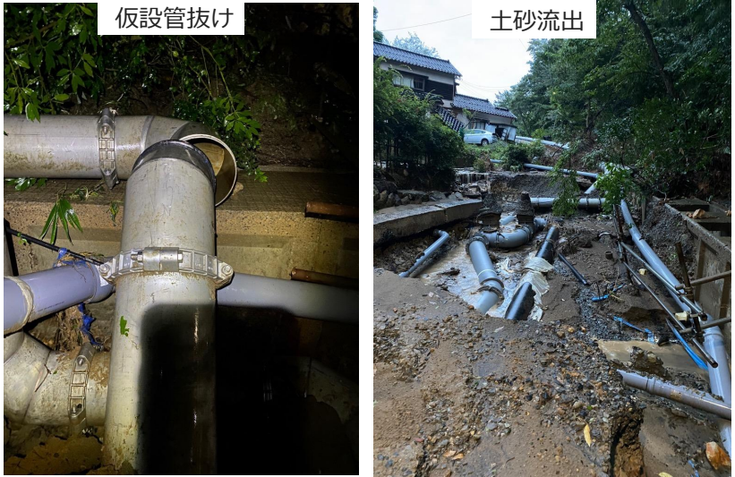
<被災状況（輪島市輪島浄水場から第1配水池への送水管）>
