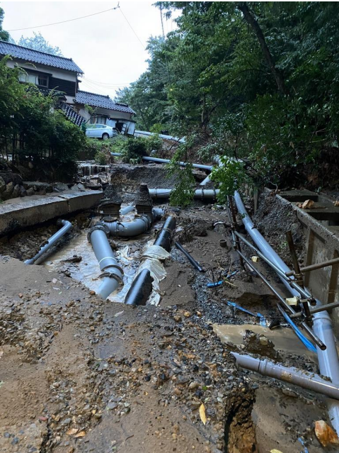
一部破損した管路
