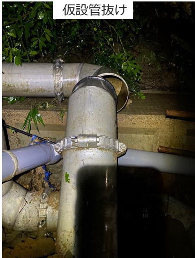
< 輪島市輪島浄水場から第1配水池への送水管 >
