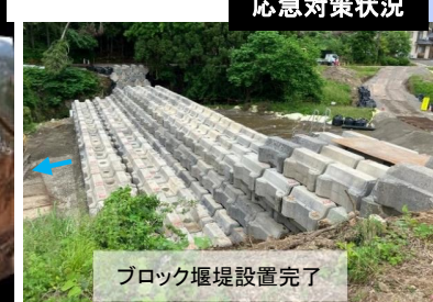
応急対策状況
