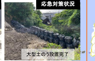
応急対策状況
