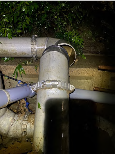
< 輪島市河井町 > 仮設管抜け（送水管）
